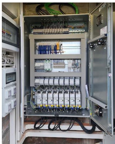
Figura 11 - Esempio di quadro simile all'applicazione richiesta installato presso le cabine del ramo N/S
